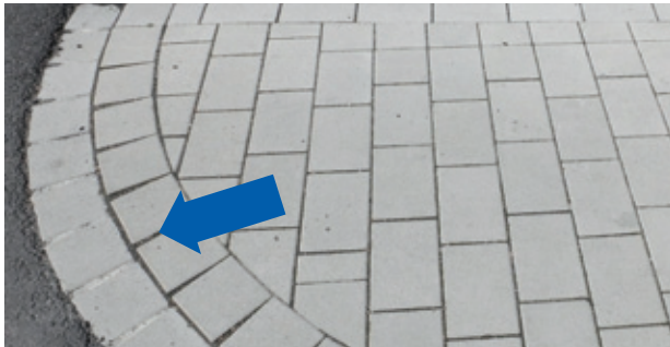
Bild 58: Durch das Verziehen der Pflastersteine entstehen Keilfugen, deren Breite zu begrenzen ist
