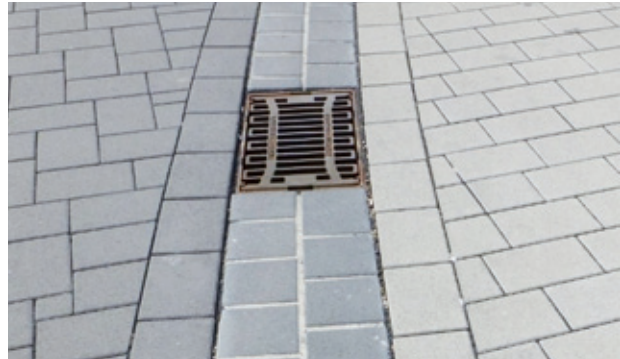
Bild 61: Positivbeispiel – Vorbildlich ausgeführte Anschlüsse bei einem beidseitigen Anschluss an eine Muldenrinne
