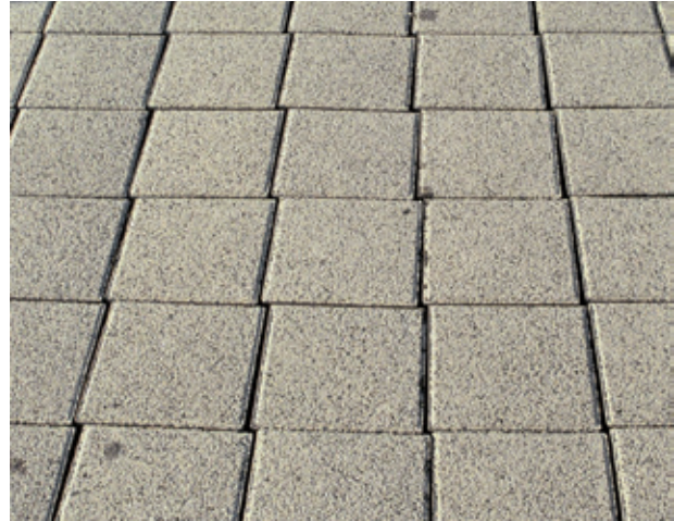
Bild 38: Schadhafte Pflasterfläche durch Abwandern des Fugenmaterials aufgrund fehlender Filterstabilität zwischen Fugen- und Bettungsmaterial
