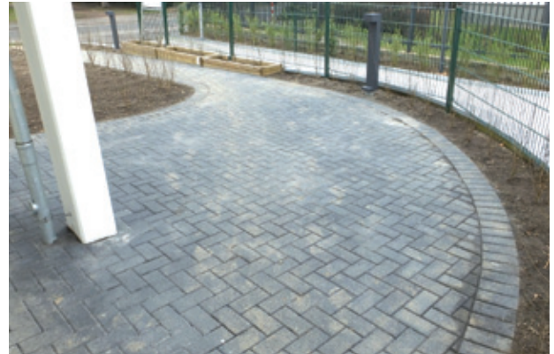
Bild 67: Pflasterdecke, bei welcher die Bauabschlussreinigung offenbar versäumt wurde. Dies kann zu hartnäckigen Verschmutzungen, zum Beispiel durch das Fugenmaterial, führen
