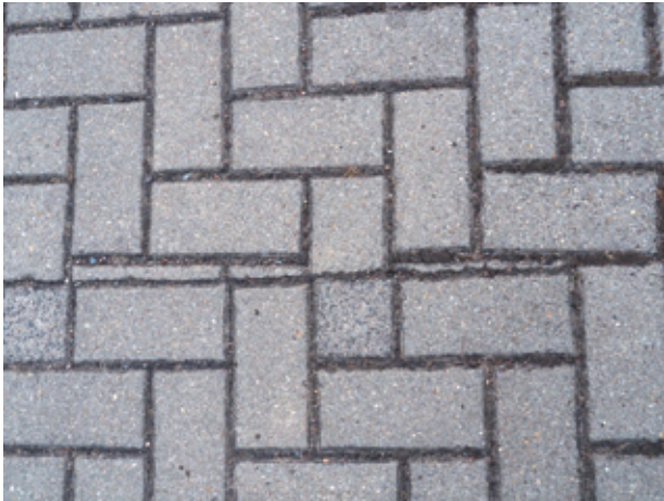
Bild 63: Negativbeispiel – Extrem schmal zugeschnittene Pflastersteine
