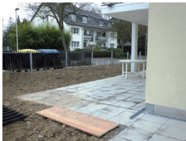
Bild 60: Plattenbelag, bei welchem die Bauabschlussreinigung offenbar versäumt wurde. Dies kann zu hartnäckigen Verschmutzungen, z. B. durch das Fugenmaterial, führen
